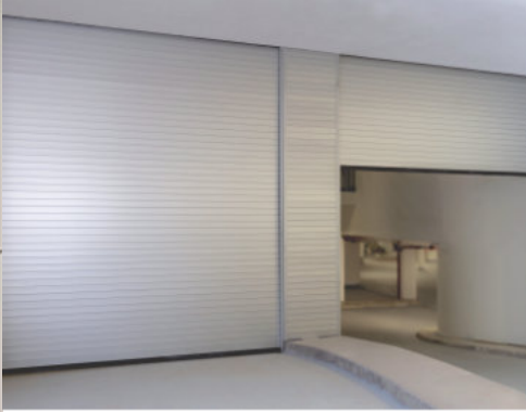
AluLine ASE in Tiefgarage
